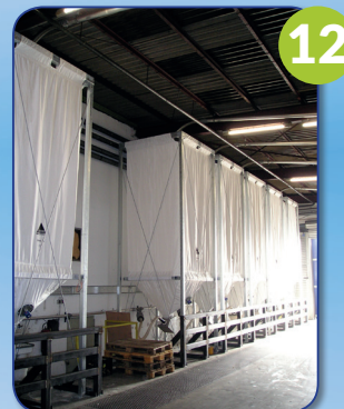
Sili di stoccaggio interni Indoor storage silos
